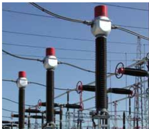
4. Transformadores de intensidad de 420 kV. Rede Eléctrica Nacional (Portugal).
