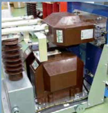
› UCL-7 Compartimento de transformadores de tensão em célula de média tensão.
