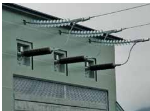
> Transformador passa-barra. Interior-exterior. Subestação de distribuição.
